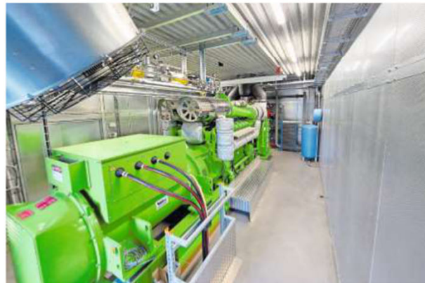
Wärme-Kraft-Koppelungsanlagen sind klein, effizient und dezentral – wie hier in einer Fernwärmezentrale in St. Gallen. Bild: Powerloop
